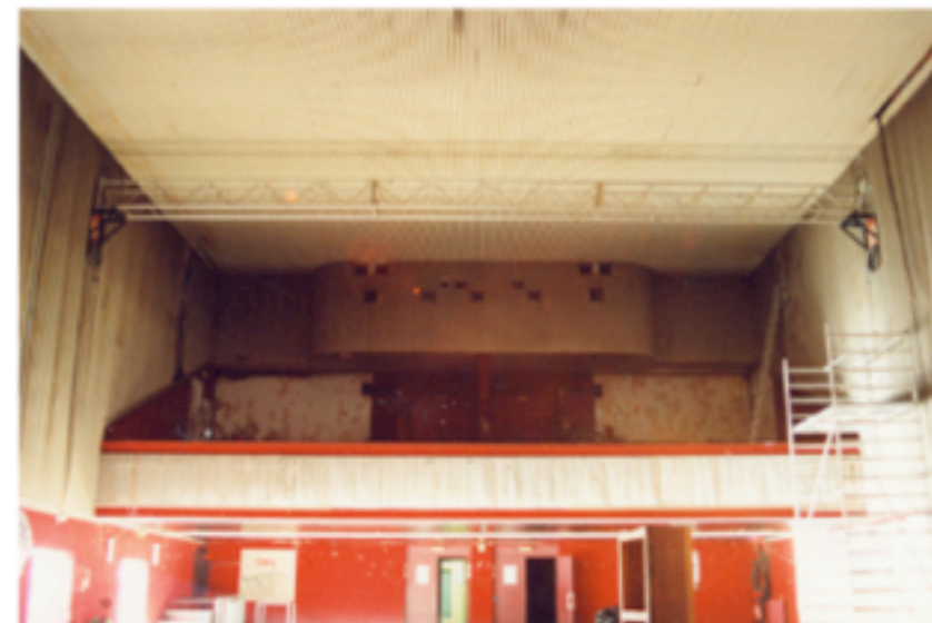
avant travaux : salle ( vue de la scène )
